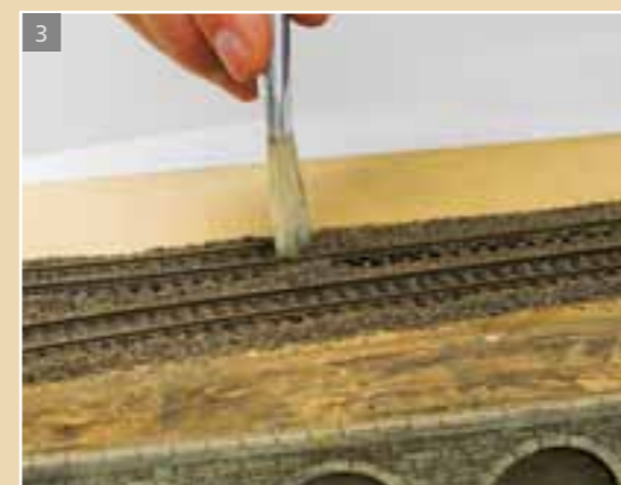
Den Schotter mit dem Pinsel von den Gleisen entfernen und gleichmäßig in die Schwellenzwischenräume kehren.
